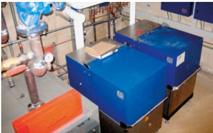
Strom und Wärme im Contracting aus der BHKW-Kaskade (Modul 1) plus Spitzenlastkessel. Rechts an der Wand noch sichtbar die Regelung (Modul 2) sowie an der Rückwand die Wärmeverteilung (Modul 3)
